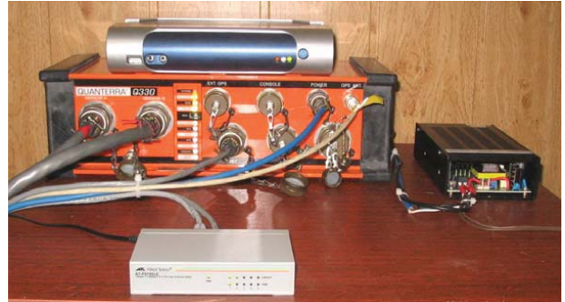
Înregistratorul Quanterra Q330 de la stația seismică Chișinău
