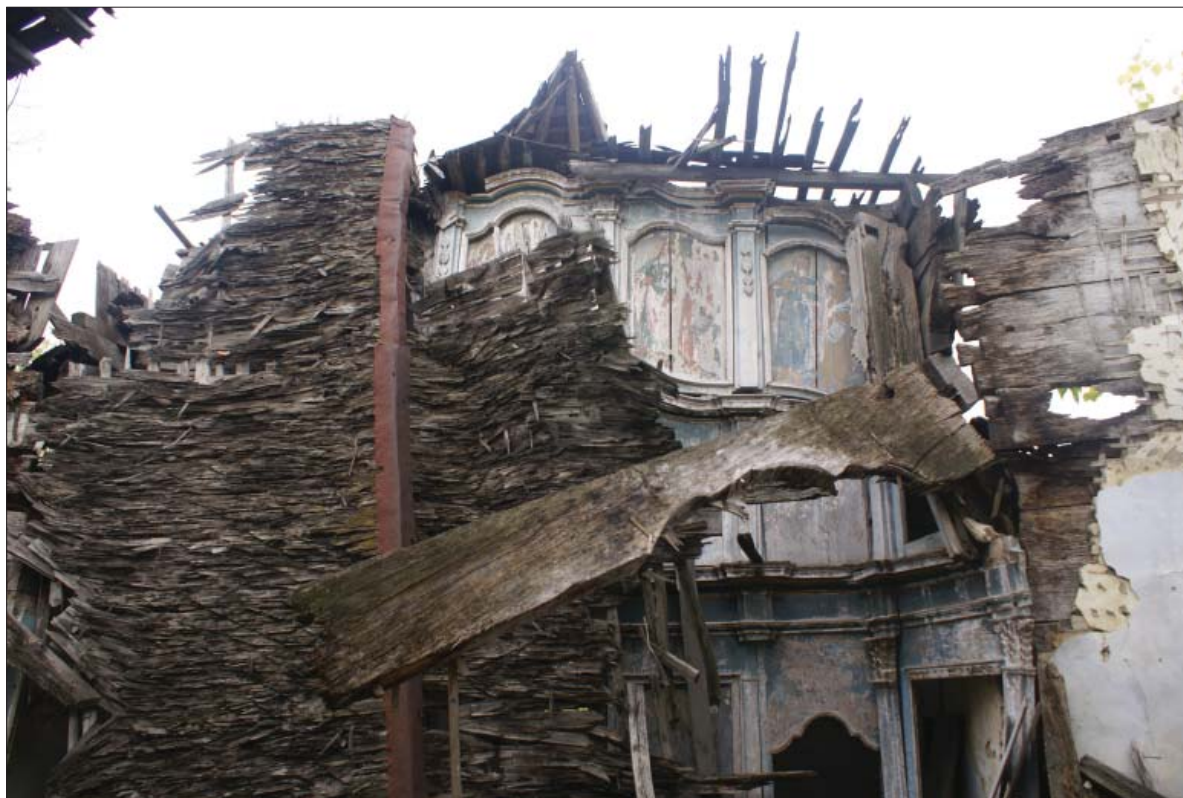
Biserica de lemn cu hramul Adormirea Maicii Domnului din satul Hirișeni, r. Telenești, în plină degradare...
